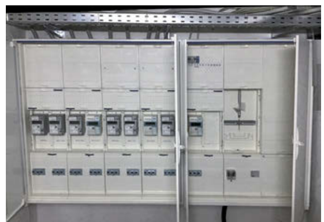
Neuer Zählerschrank im Keller
