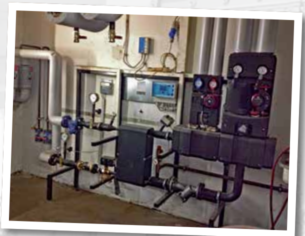
Neue Heizzentrale im Gerbodoweg 10 in 69123 Heidelberg-Wieblingen
